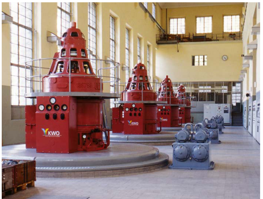
Blick in den Maschinenraum des Kraftwerks «Handeck 1»
